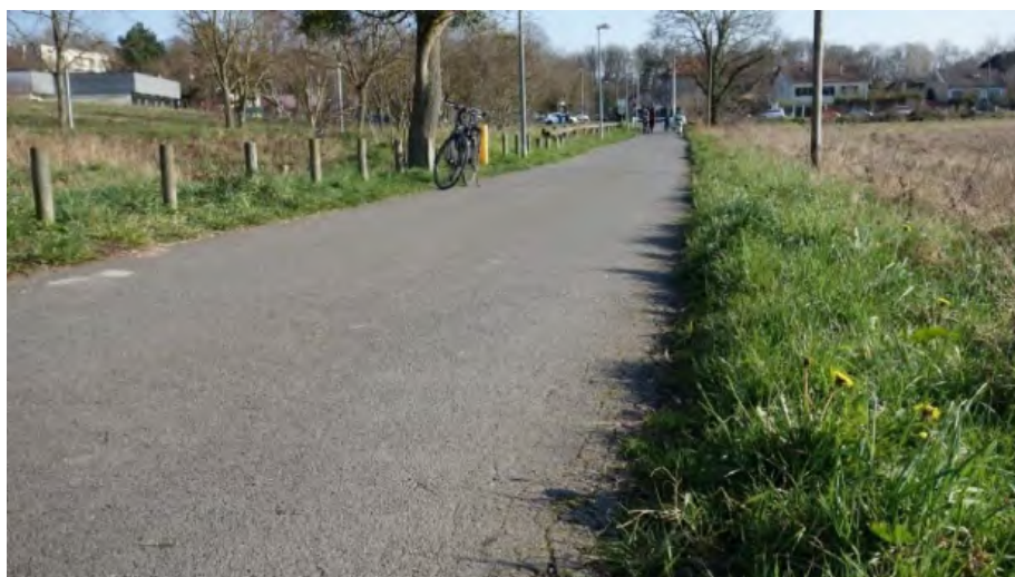
Ex. 1 : Enrobé bitumineux classique ancien (> 30 ans ?), Chemin du bac de Ris à Draveil (91)
