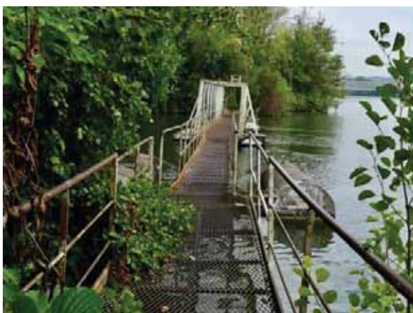
12. Passerelle à reconstruire (photo E. Marchandise)
