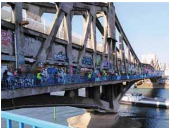
La passerelle des câbles : un ouvrage d'art ancien qui a besoin d'être réhabilité (photo Ph. Ungerer)
